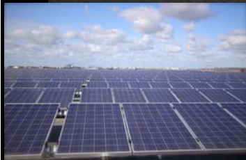
4 600 Fotovoltaïsche Panelen 1 MW piek
